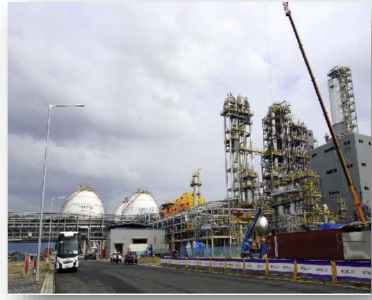
Dự án: Nhà máy sản xuất POLYPROPYLENE HYOSUNG – PP4 Nhà thầu: Công ty CP VIMECO Project: POLYPROPYLENE HYOSUNG – PP4 Factory Contractor: VIMECO Joint Stock Company
